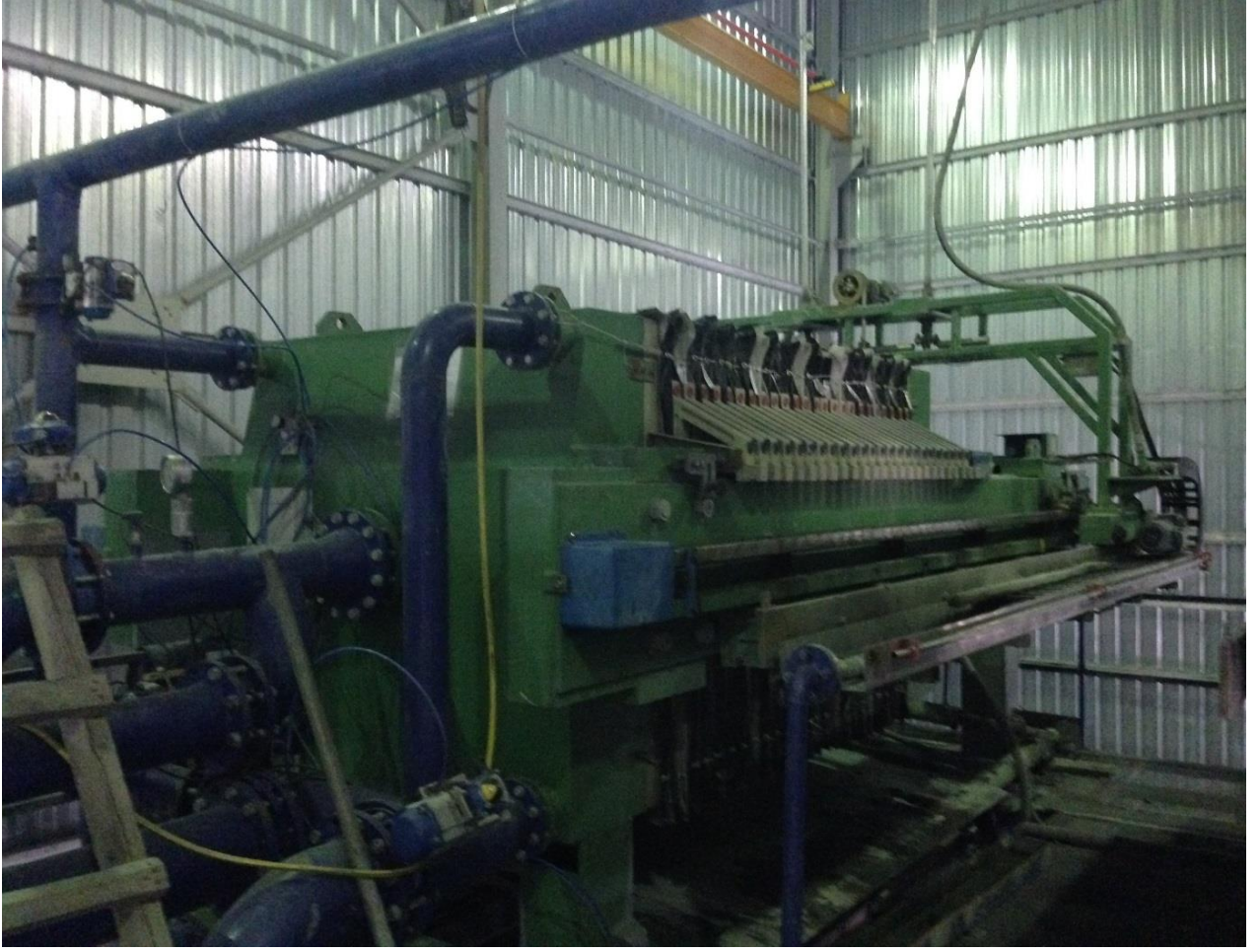
Fotoğraf 7. Atık filtre pres ünitesi
